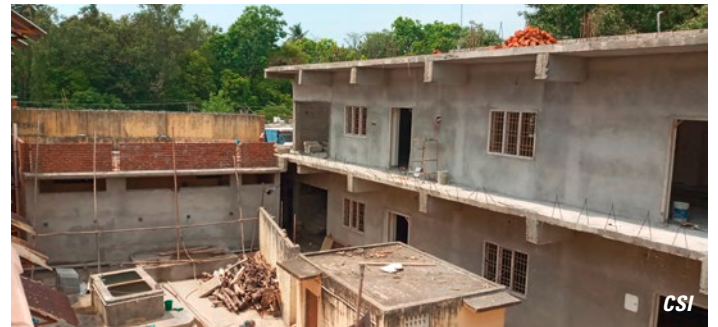
Im Juni 2020 waren die Bauarbeiten für das Mädcheninternat der St Antony Schule in vollem Gange.
